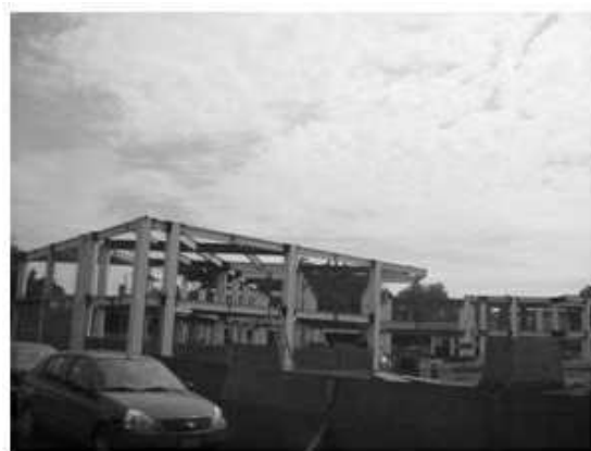
Vista lateral de los trabajos de montaje de estructura metálica del edificio del Cendi
