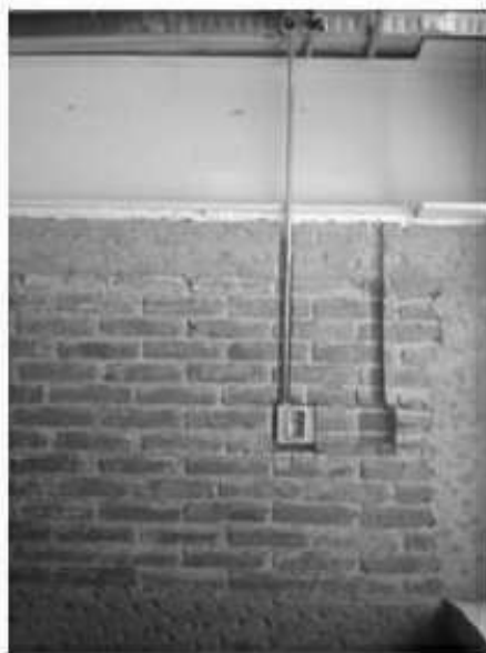
Colocación de tubería conduit y ranurado para cajas para las instalaciones eléctricas
