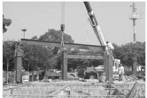
Vista de la colocación de estructura metálica a base de columnas y traveses metálicas
